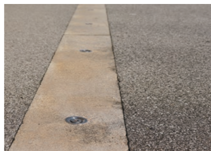
弊社の周辺道路や敷地内は、積雪や凍結を防ぐために地下水を散水するための設備が埋め込まれている。雪国ならではの光景。
